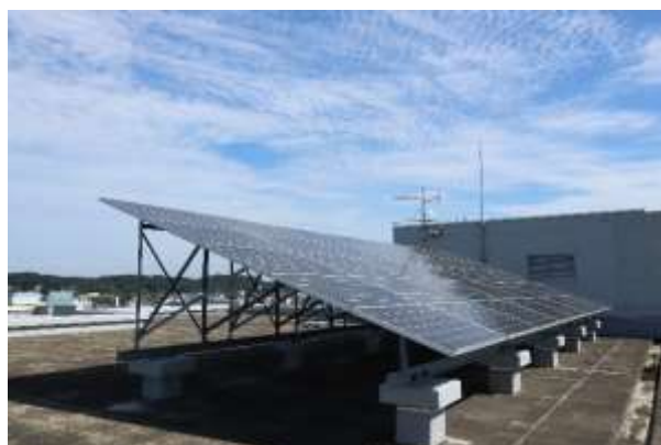
東金中学校屋上に設置された非常電源用太陽光パネル
