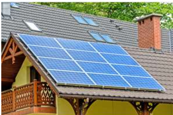
太陽光パネル
